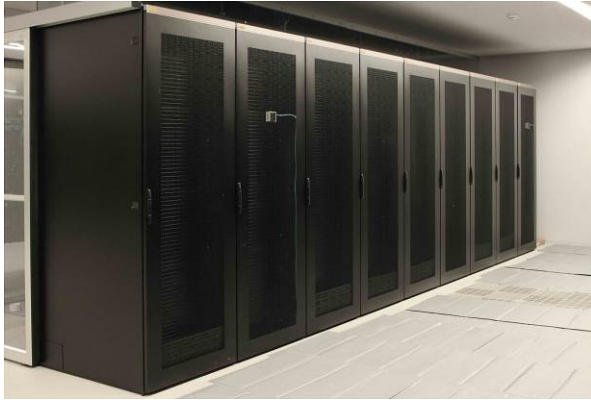
図1 施工前のラック
