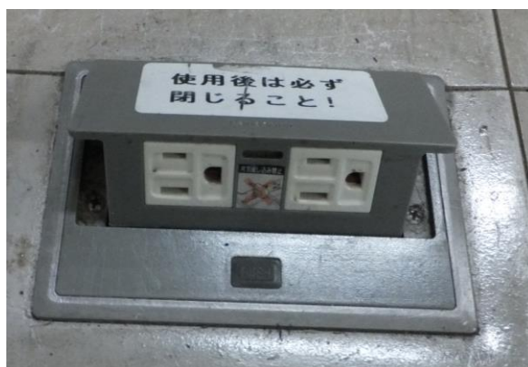
図 3. 改良前のコンセント
