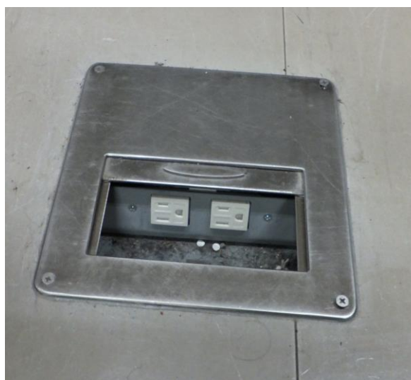
図 4. 改良前のコンセント
