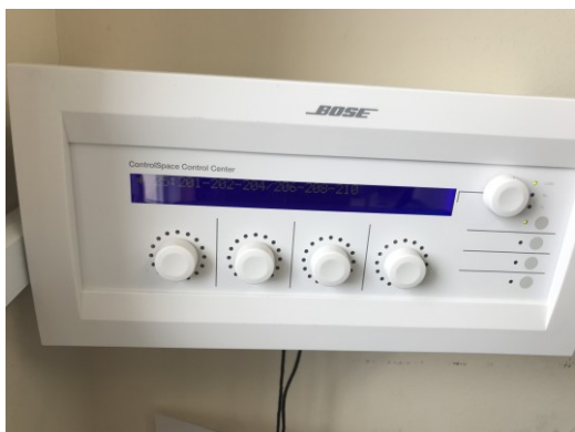
写真5 音響制御パネル
