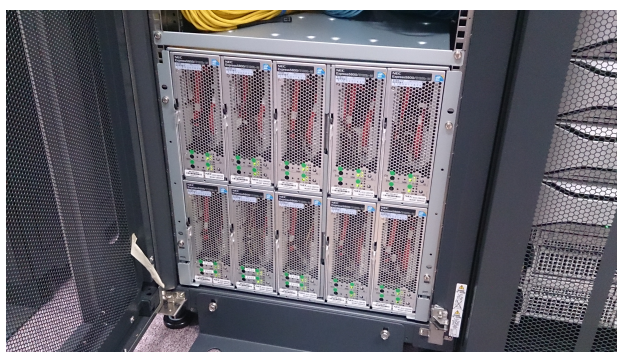
図 2: NEC ECO CENTER 20 ノード
