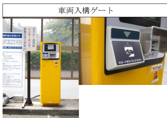
図 12. 車両入構ゲートサービス機器
