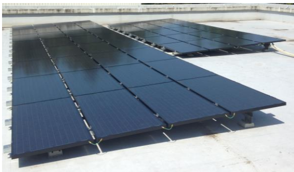
図 1 太陽光パネル(場所:モラロジー研究所屋上)
