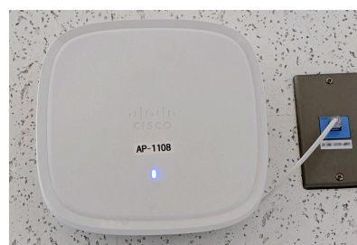
図1 小金井キャンパス内の建物の天井に設置されているWi-Fi アクセスポイントの例 (Wi-Fi アクセスポイント名: AP-1108)。
