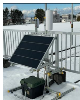
図 9 太陽光パネルによる基地局の設置。
