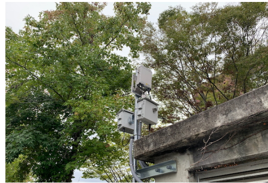
図 3 屋外 RU 設置の様子
