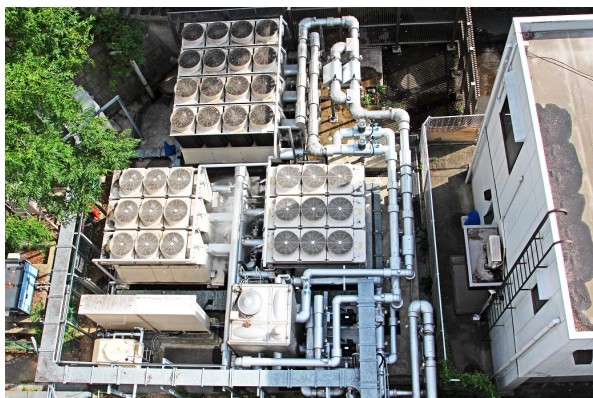
図3 冷却設備の屋外設備写真
