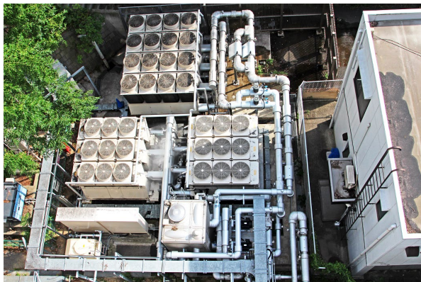
図3 冷却設備の屋外設備写真
