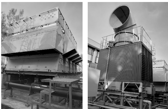
図 2：空冷チラー（左）と冷却塔（右）
