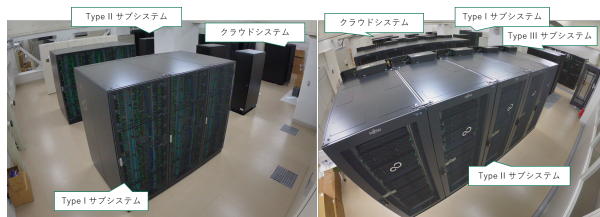
図 2 スーパーコンピュータ「不老」の外観写真 (計算機室の奥からと手前から)
